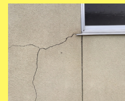
ひびわれ・クラック
